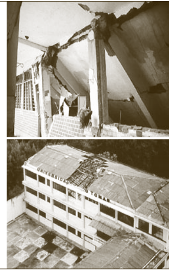
Figure 1 Dommages matériels dans des installations universitaires après le tremblement de terre de 1999 à Quindio (Colombie)
