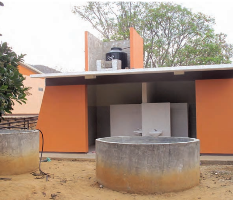
■ Figure 3.9 ■ Water tanks for rain storage, Artículo 3ro Constitucional, Los Octores, Oaxaca © Alastair Blyth
