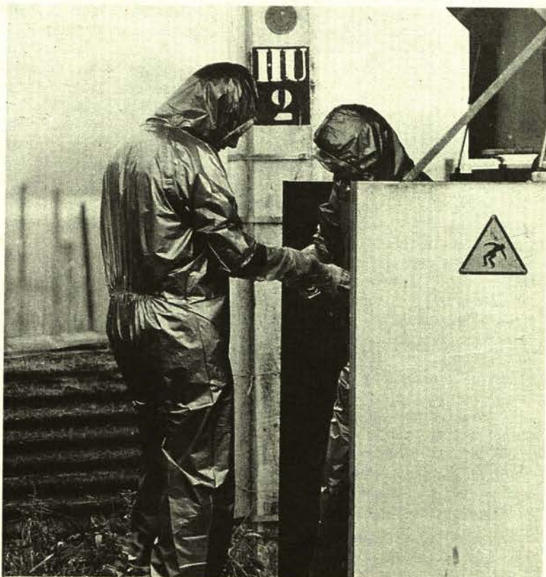
Transformateur au Pyralène, produit chimique de la famille des PCB, endommagé par la foudre près de Lille.
