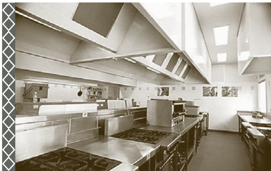
Équipements de cuisine au Goulburn Ovens Institute of TAFE, Seymour Campus, Seymour, Australie
